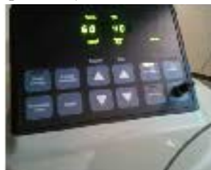
Imagen 24.2.4: El panel se enciende conectando la llave en el interruptor y el detector de energía. Al fondo el panel de control.
